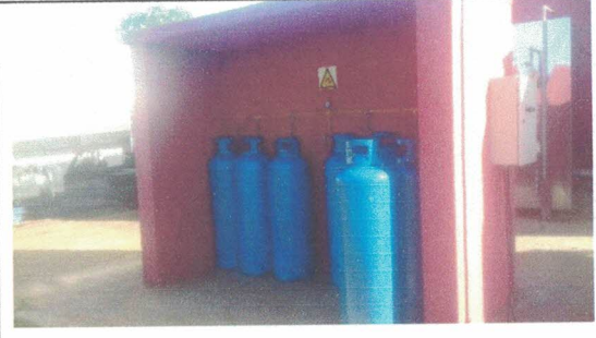
Foto 18. Casa de gás com 6 botijões instalados e 2 botijões extras.
